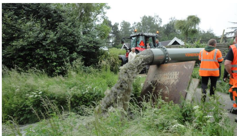
Pumpning ved Berberisvej
